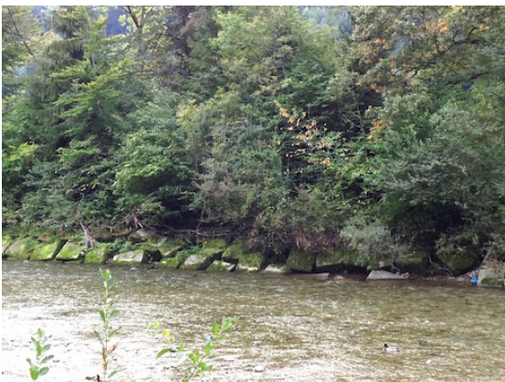
Unterspülte Betonquader im Bereich Sensematta. (Foto Flussbau AG SAH)
