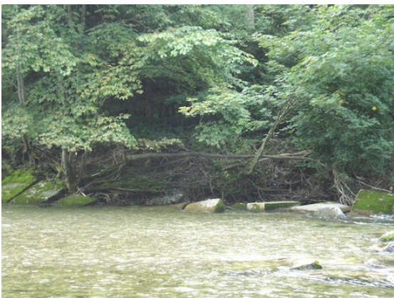
Zerstörter Uferschutz linksseitig im Abschnitt Noflenau. (Foto Flussbau AG SAH)
