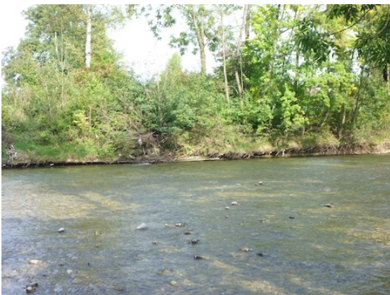
Unterspülter Uferschutz im Bereich Neuenegg. (Foto Flussbau AG SAH)
